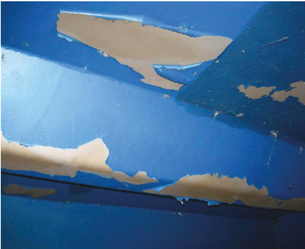
Abbildung 14: Schadensfall aus dem Wiederlagerbereich einer Brücke mit abgängiger blauer Polyurethan-Deckbeschichtung (Bild: Bundesanstalt für Straßenwesen).
